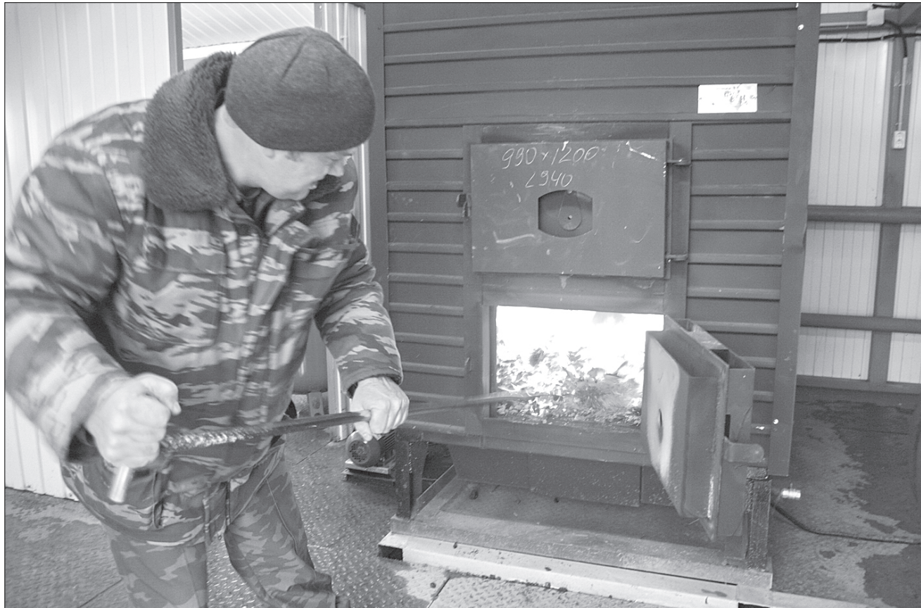
Температура в детском саду и амбулатории поселка повысилась практически сразу же после запуска котельной.
