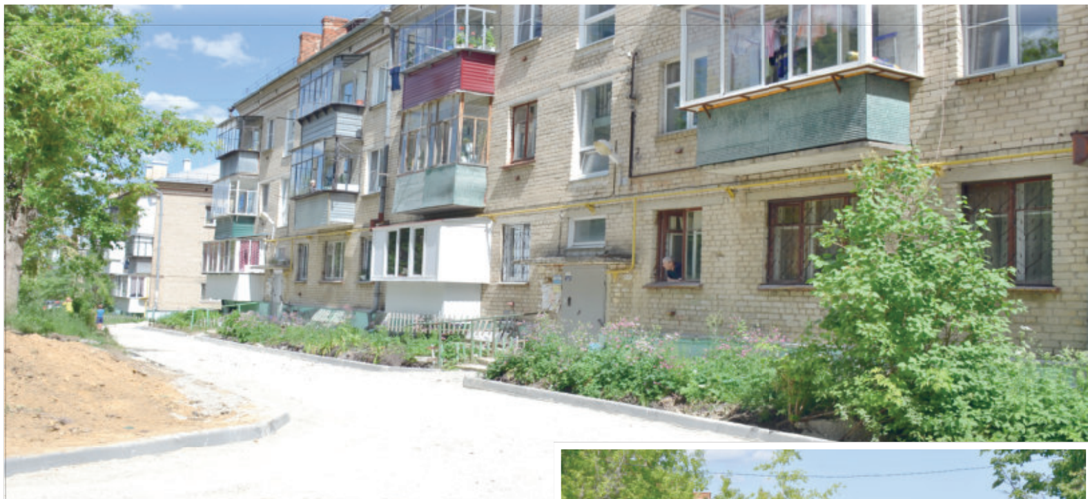
В 2019-м подрядчик не успел выполнить ремонт во дворе дома № 16 на улице Готвальда. Работы будут проведены в этом году.
