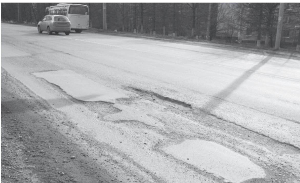
Все жители помнят, как капитально ремонтировали дорогу на пр. Октября. Не так давно это было. Глядя на проспект, этого не скажешь.
