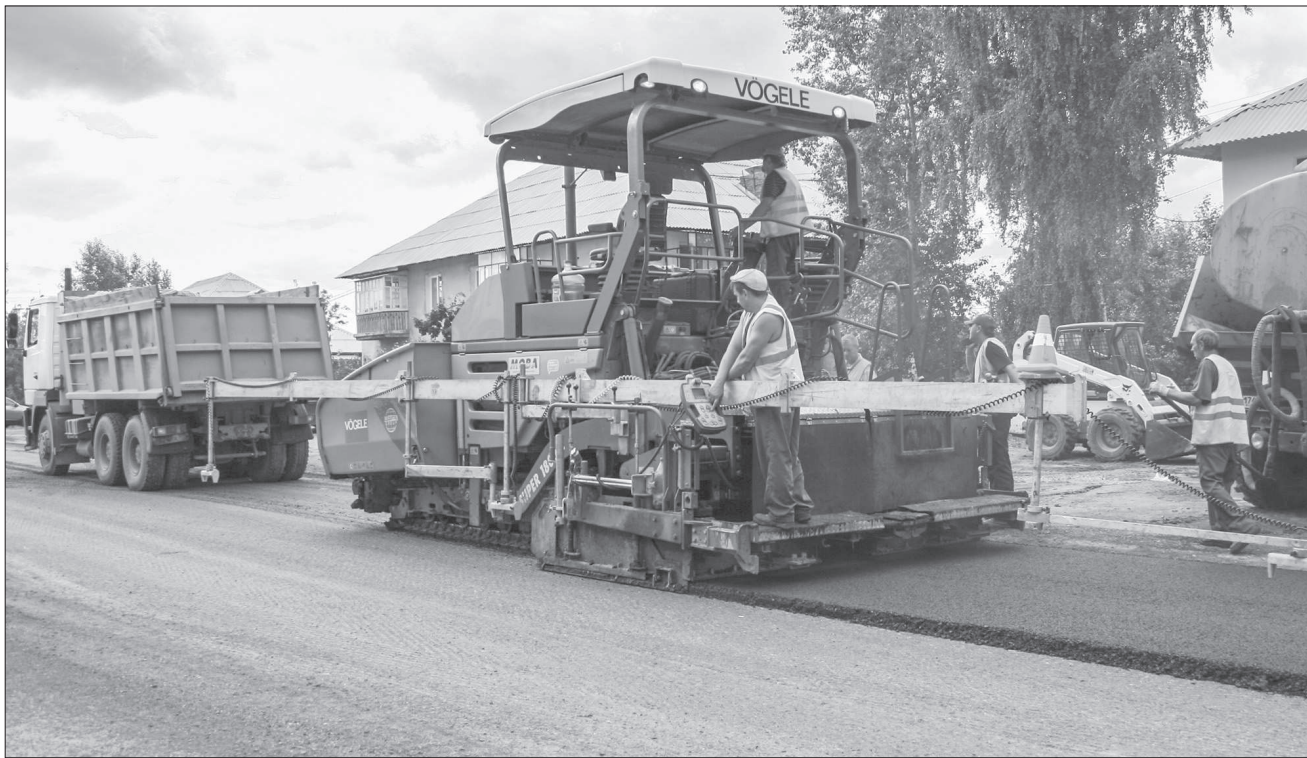
Подрядчик, уложивший в 2010 году некачественный асфальт, на минувшей неделе приступил к гарантийному ремонту.
