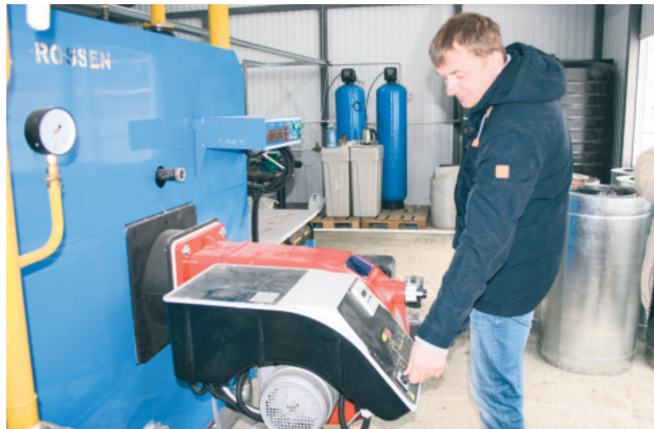
В начале октября запущена новая газовая котельная в районе ПАТП, тепло пришло в дома.
