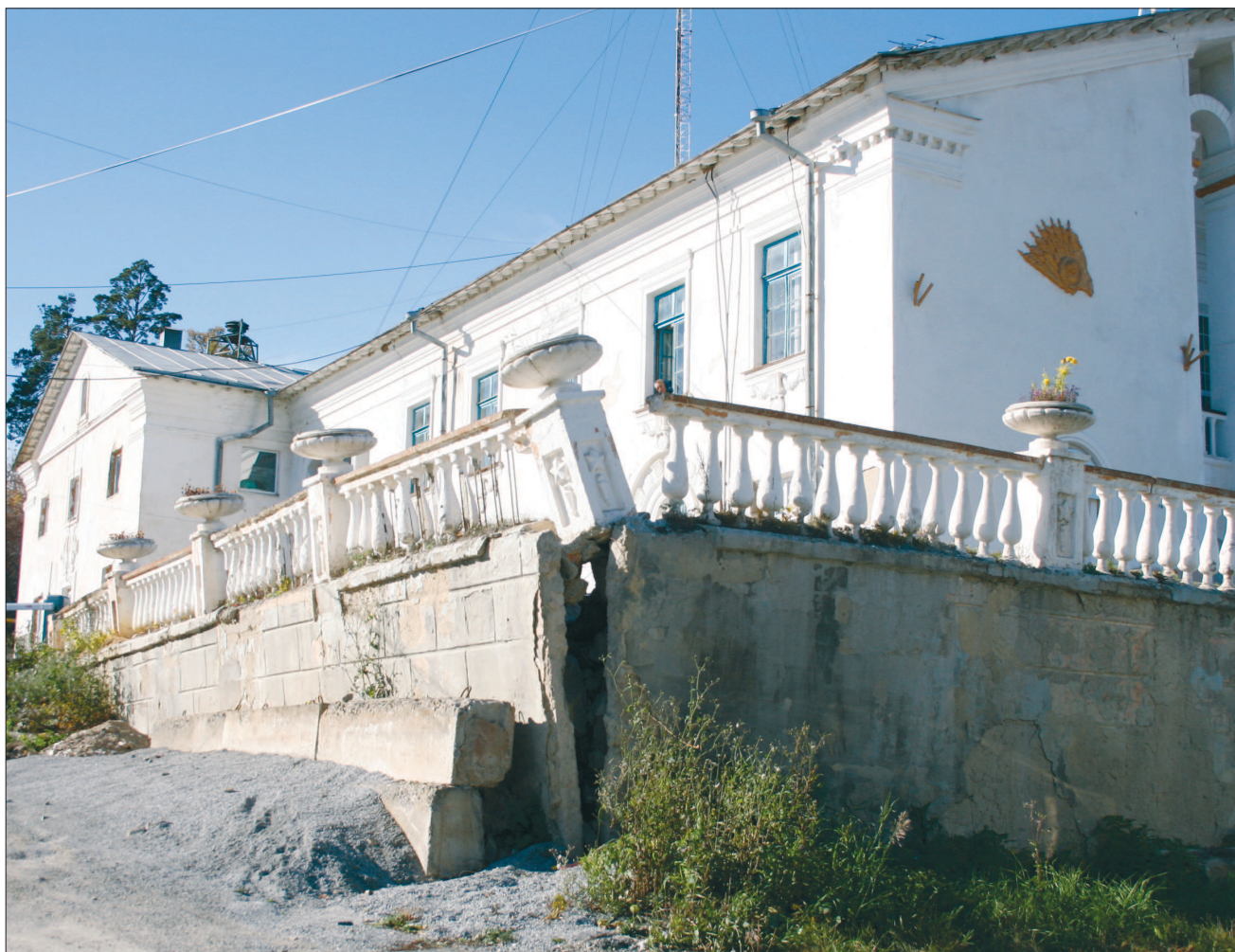
Арендатор заверил, что ни стена, ни колонна на головы горожан не обрушатся.
